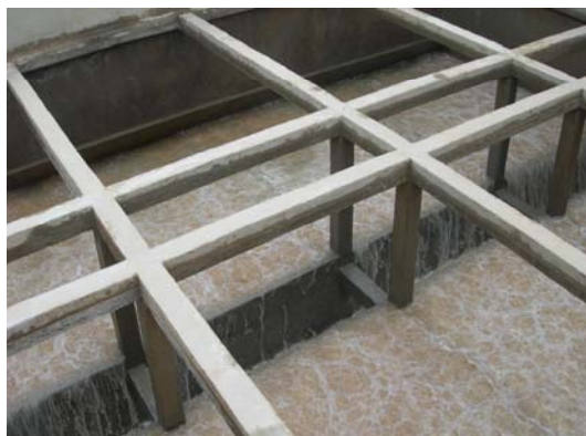
FUENTE: Fotografía tomada por el equipo auditor durante la visita a los filtros de la planta potabilizadora "Los Berros".
