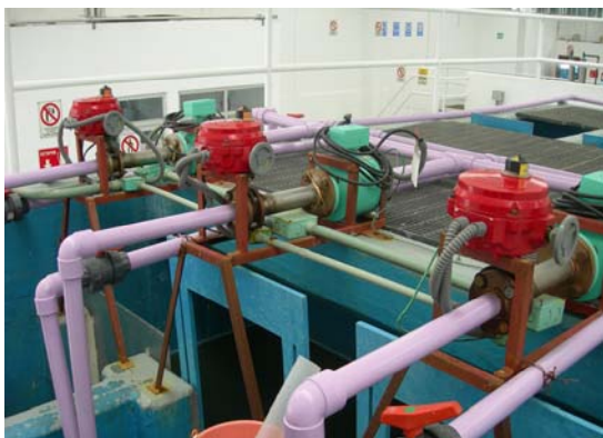
FUENTE: Fotografía tomada por el equipo auditor durante la visita a la planta de cloración de la planta potabilizadora "Los Berros".
