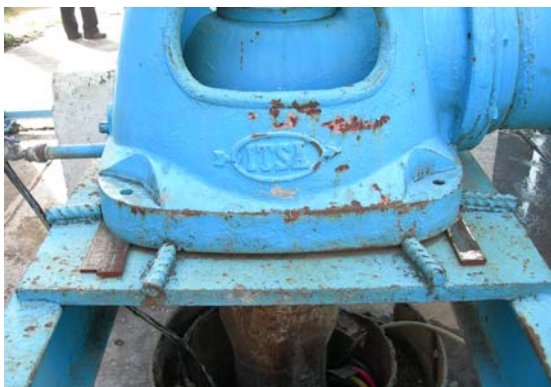
FUENTE: Fotografía tomada por el equipo auditor durante la visita a un pozo en rehabilitación del Ramal Mixquic-Santa Catarina, del Plan de Acción Inmediata.
